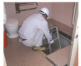
保守点検作業
