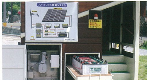
機械・バッテリー室
