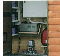
後側上部機械室
