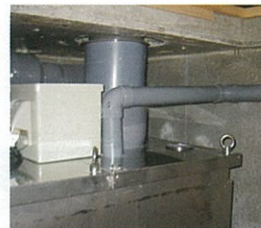
ピット内処理槽・配管
