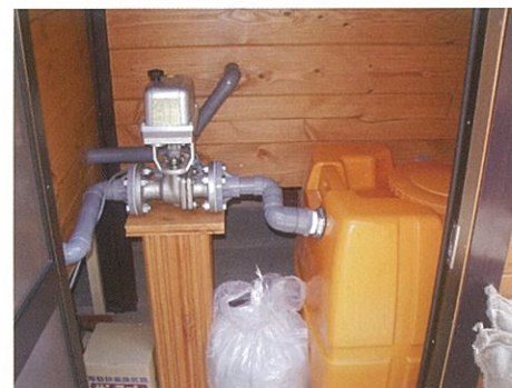
機械室内尿分離
