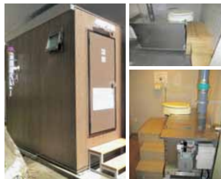
兵庫県 神戸市 阪神高速道路 妙法寺換気所 MDBR-PK1-M型-SB-KB(左) 二軒茶屋換気所 バイオR21-L型-SB-KB(右) 新有野TN機械室内 バイオR21-M型-SB-KB(右)
