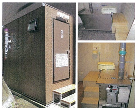
兵庫県 神戸市 阪神高速道路 妙法寺換気所 MDBR-PK1-M型-SB-KB(左) 二軒茶屋換気所 バイオR21-L型-SB-KB(右上) 新有野TN機械室内 バイオR21-M型-SB-KB(右下)
